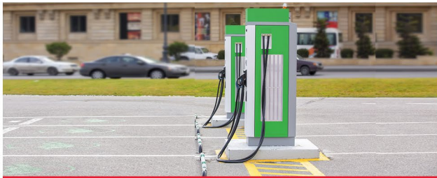
Stacja ładowania samochodów elektrycznych
